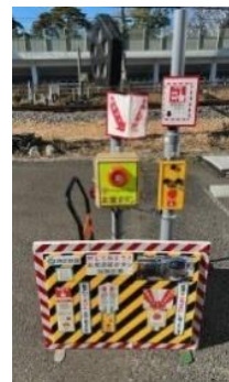
【踏切報知ボタン】
